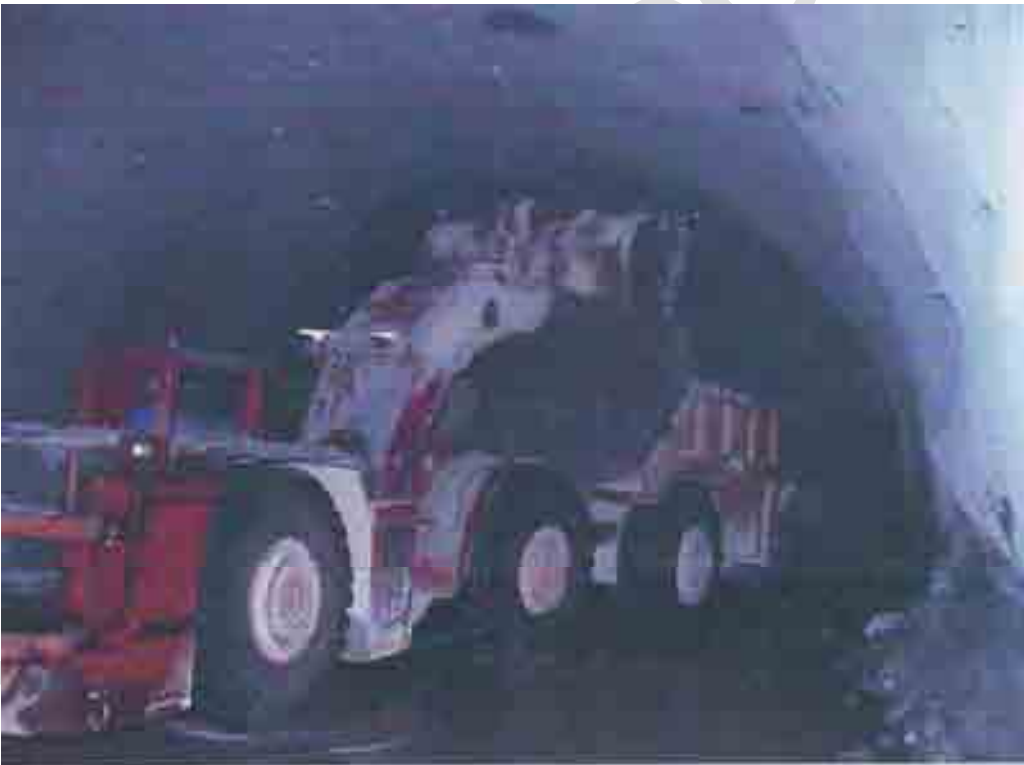
Công tác bốc xúc đất đá khi thi công Hầm Hải Vân
