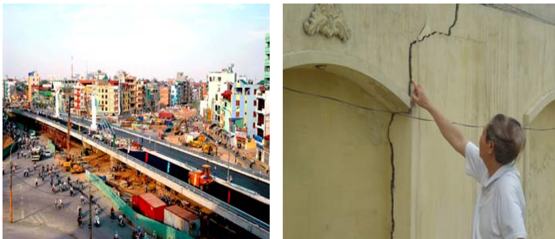
Hình 13. Cầu vượt Ngã Tư Sở và các tường nhà dân tại Ngã Tư Sở bị lún nứt
