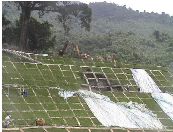
Hình 7. Sụt lở phát triển tới bề mặt tại cửa hầm phía nam dự án hầm Hải Vân
