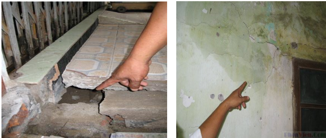
Hình 12. Các khu nhà liền kề bị lún nứt
