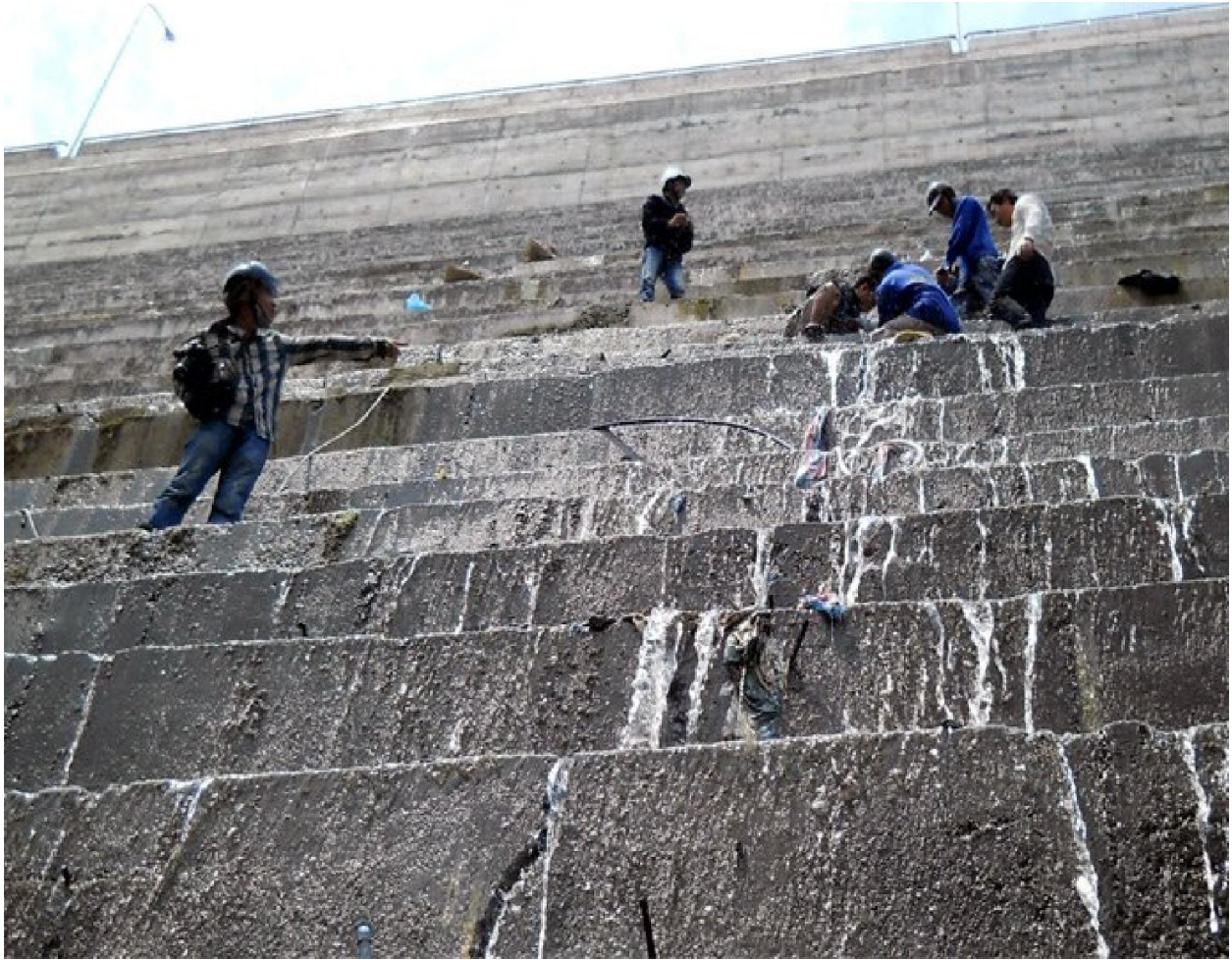
Thủy điện sông Tranh 2 từng bị rò rỉ nước khiến nhiều người lo sợ.
