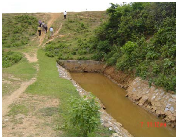
Kênh mương bị xạt lở, xuống cấp rất nhanh nếu quản lý kém
