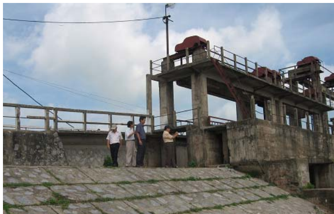
Cống đập Trà Linh (Thái Bình) được xây dựng gần 50 năm trước đây
