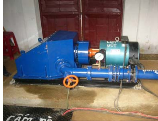
Hình 9. Trạm thủy điện Mai Thêu - Tự động hoá cao
