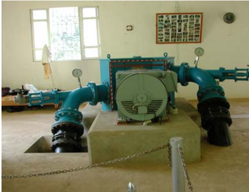
Hình 8. Trạm thủy điện Nà Trá công nghệ tự động không người điều khiển
