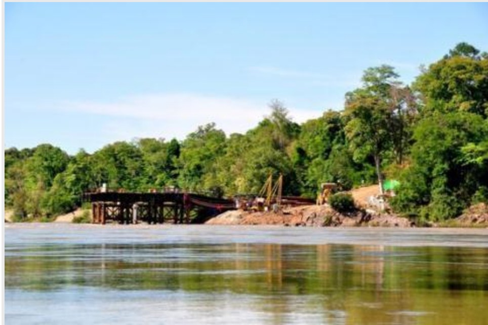
Cây cầu nối đất liền với đảo Don Sadam đang được xây dựng chứng minh các bước chuẩn bị cho việc xây đập đang được rất ráo chuẩn bị
