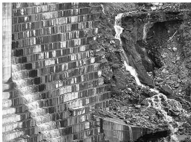
Nước chảy ra hạ lưu đập Sông Tranh 2
