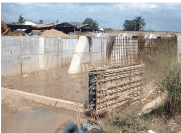
Đường thoát nước của dự án KLFMP [24]
