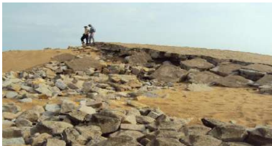
Hình 19: Hư hỏng công trình bảo vệ bờ tại Cửa Đà Nông, Phú Yên
