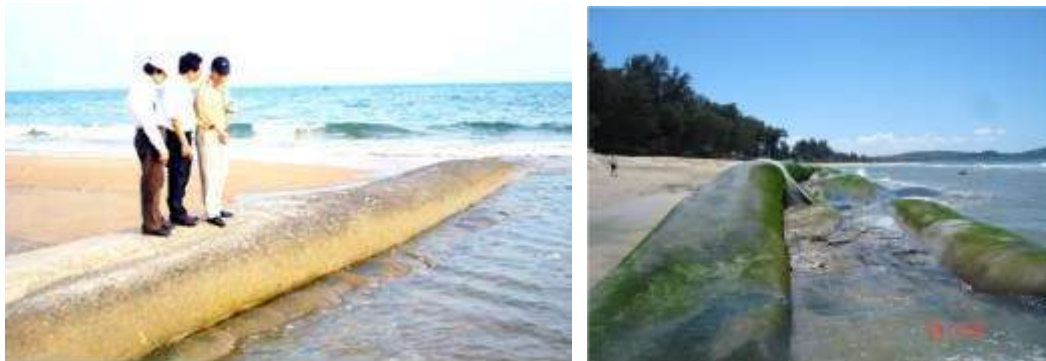
Hình 13: Công nghệ Geo-Tubes được ứng dụng thành công tại biển Lộc an, Bà Rịa-Vũng tàu (trái) và thất bại tại Đồi Dương, Bình Thuận (phải)
