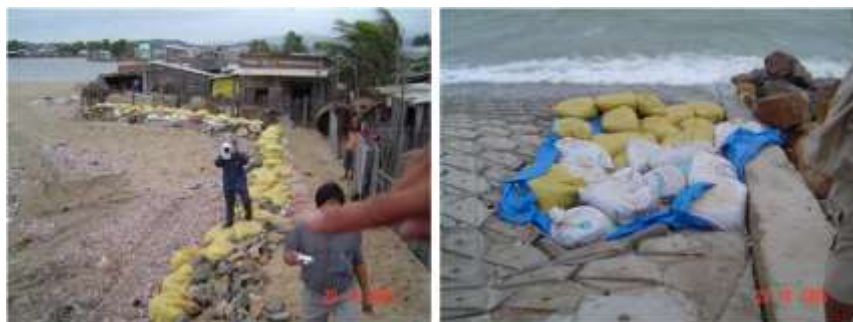
Hình 18: Hư hỏng kết cấu bảo vệ mái do mất ổn định nền tại bờ biển Bình Thuận.
