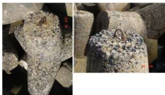
Hình 17: Vấn đề ăn mòn bê tông tại các kè mỏ hàn và kè lát mái tại Bình Thuận.
