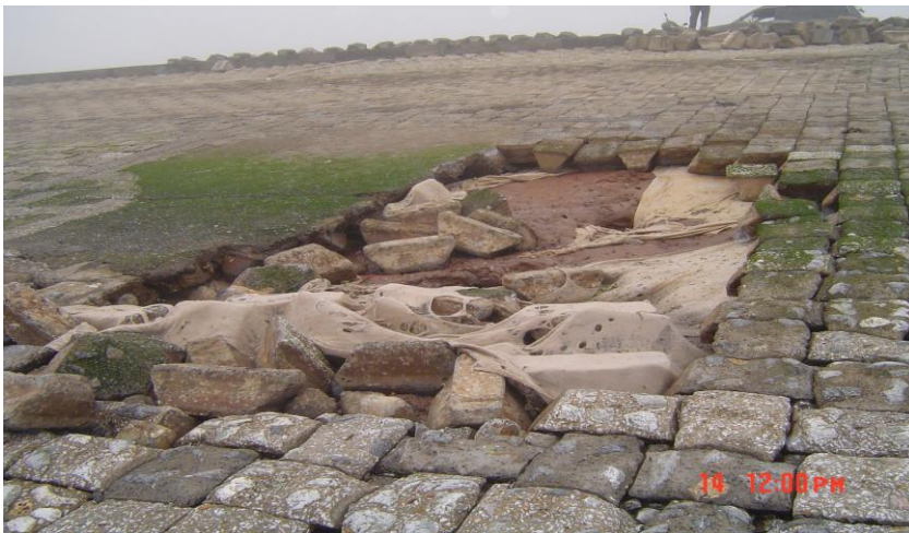
Ảnh 1: Kè đê biển bị sập do sóng
