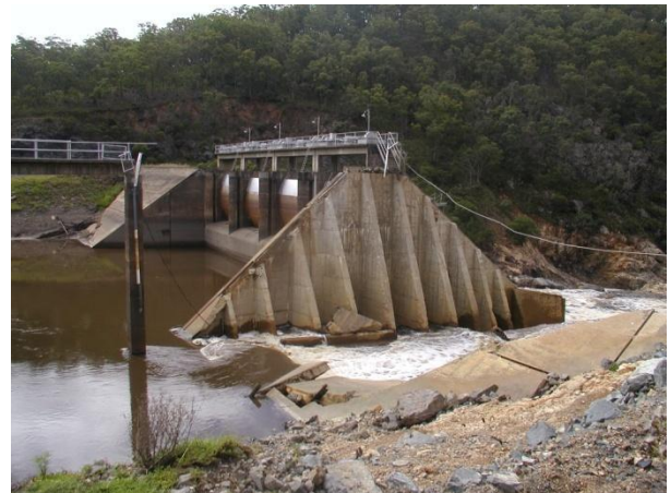
Hình 9: Vỡ ở đập Oaky River, Australia
