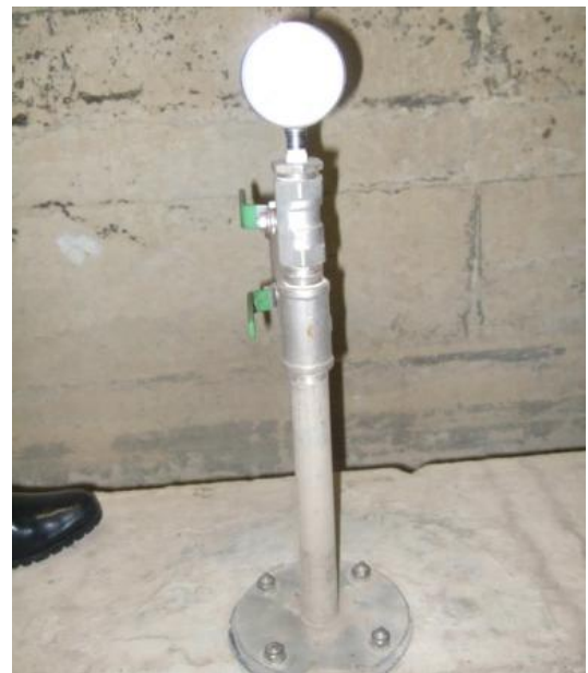
Hình 10. Thiết bị đo áp lực thấm ở Đập Kamasa (Nhật)
