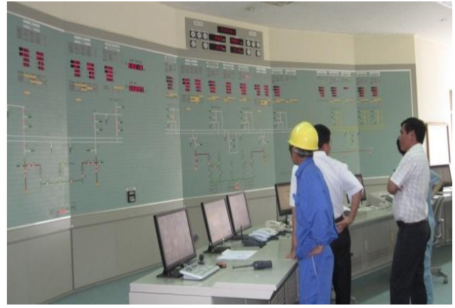
Hình 8. Hệ thống giám sát ở nhà máy Hàm Thuận (Bình Thuận).
