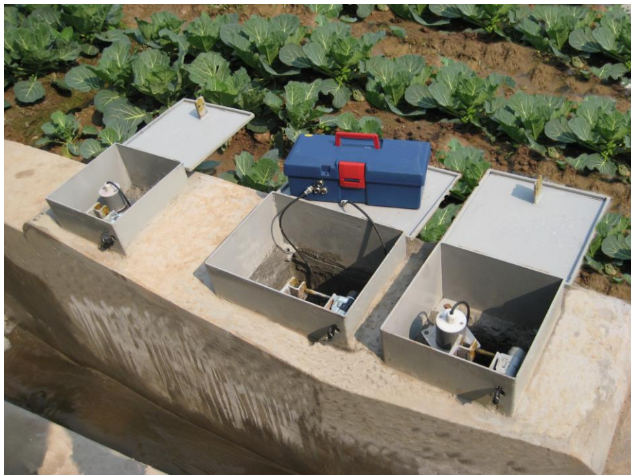
Thiết bị kiểm soát lượng nước phân phối trên hệ thống kênh tưới được lắp đặt tại hệ thống thủy nông Áp Bắc – Nam Hồng, Đông Anh Hà Nội
