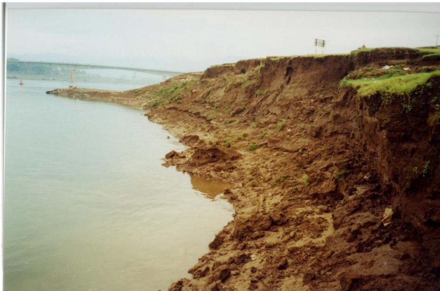
bờ hữu sông Đà bị sạt lở
