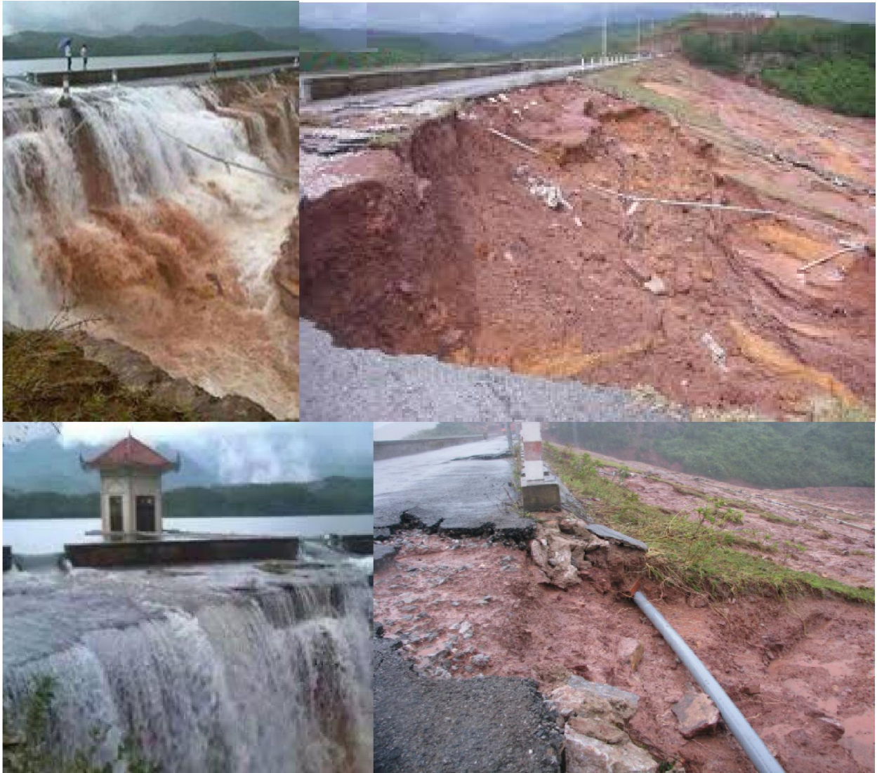
Đập chính bị tràn và hư hại nặng
