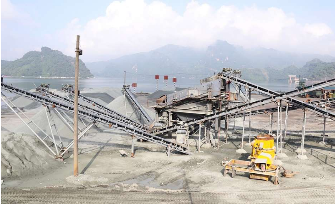
Khu vực sản xuất cốt liệu cho bê tông phục vụ thi công Nhà máy Thủy điện Hòa Bình mở rộng
